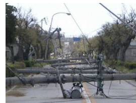
▲台風14号(H15.9)の被災状況
